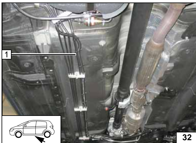
Brennstoffleitung und Kabelbaum Dosierpumpe 1 ab Mitte Spritzwand in Wellrohr Ø 10 (2100mm)!
