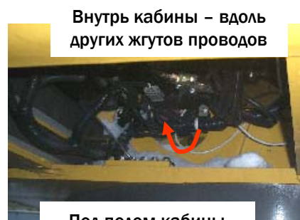
Под полом кабины (под нижним щитком)
