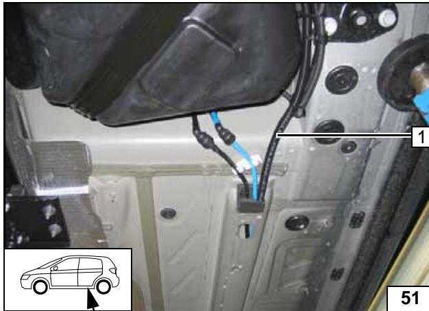
1 Brennstoffleitung und Kabelbaum Dosierpumpe in Wellrohr
