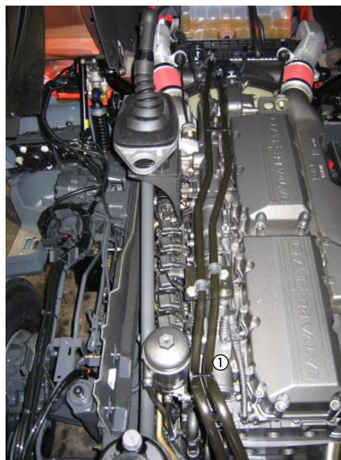
① Wasserrohre vom Heizgerät zum Wärmetauscher Water pipes from the heater to the heat exchanger
